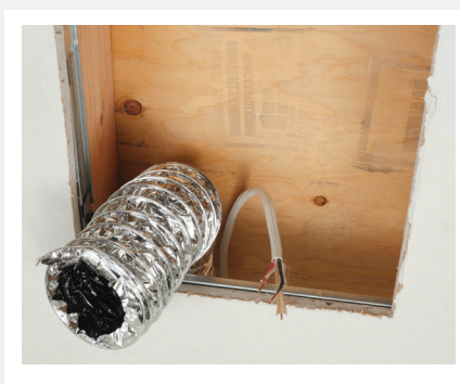
Conduit de 3 po et câblage existants
